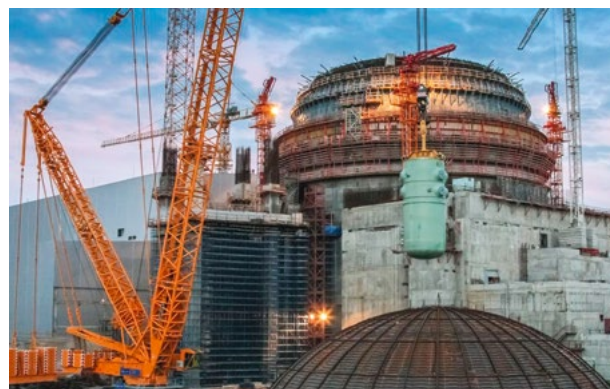
Энергоблок № 1 Ленинградской АЭС-2
