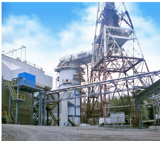
Сероулавливающая установка №2 (ПС-1)
