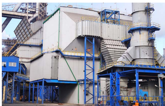
Электрофильтр системы аспирации литейного двора доменной печи №6
