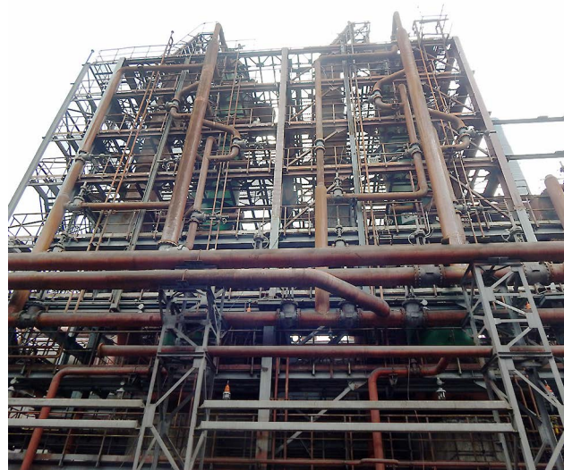
Теплообменники охлаждения коксового газа
