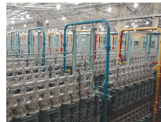
Центрифужное производство (АО «УЭХК»)
